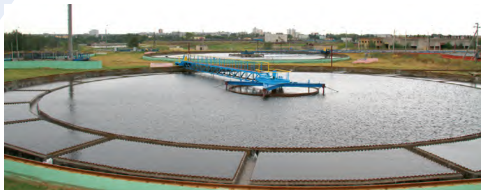
Минская станция аэрации
